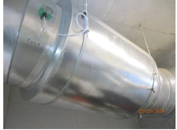
Kuva 8.12 IV-konehuoneessa kanaviston äänenvaimennin
