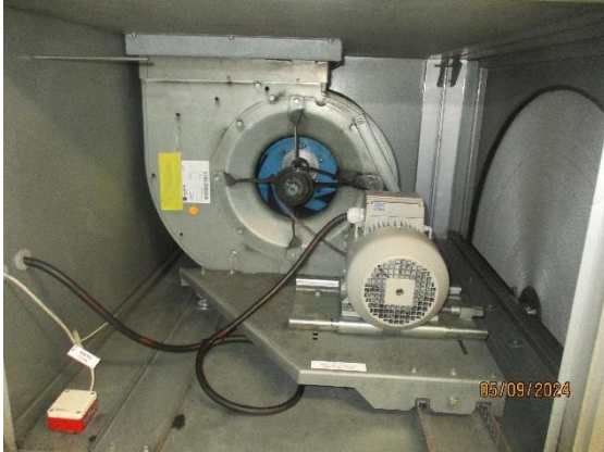
Kuva 8.5 TK04 hihnavetoiset puhaltimet.
