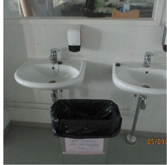
Kuva 6.7 Jakojohdot koteloissa, kytkentäjohdot maalattua kuparia.
