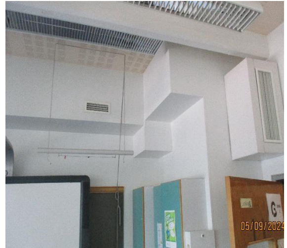
Kuva 8.16 Luokkahuoneiden ilmanjako säleikköjen kautta
