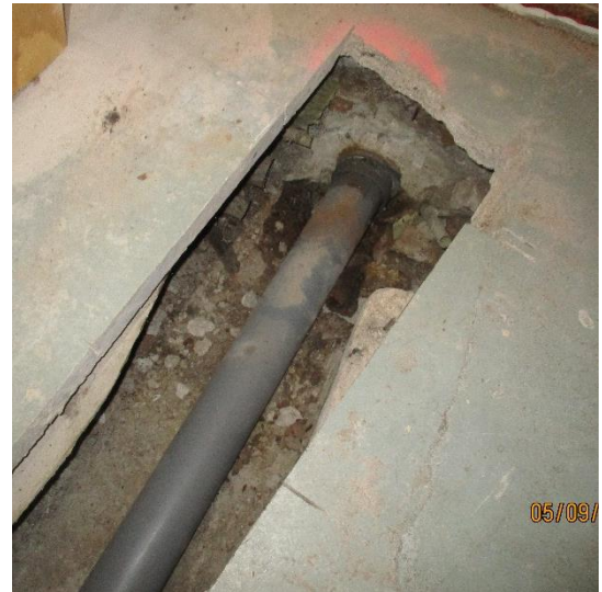
Kuva 6.11 Pohjaviemärit kulkevat muovisena sekä valurautaisena lattiarakenteessa
