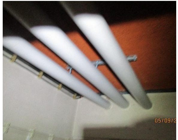
Kuva 6.5 Käyttövesiputkistoa kellarikerroksen tiloissa. Putket on kannakoitu kattorakenteisiin ja putkien eristys päällystetty PVC-kourulla.
