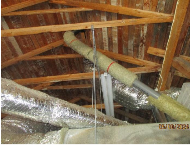
Kuva 6.8 Ullakkotilan tuuletusviemäreissä puutteita eristyksissä.
