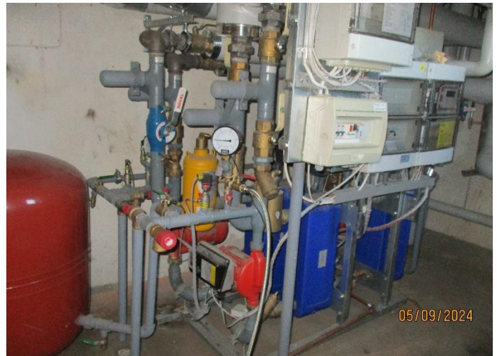
Kuva 5.2 Kaukolämmön ala-jakokeskus lämmönjako-huoneessa.
