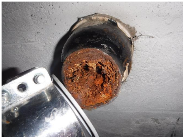
Kuva 6.26 Vanha valurautaviemäri, jonka kivettymä on melkein tukkinut. Syöpymä edennyt melkein seinämän läpi.
