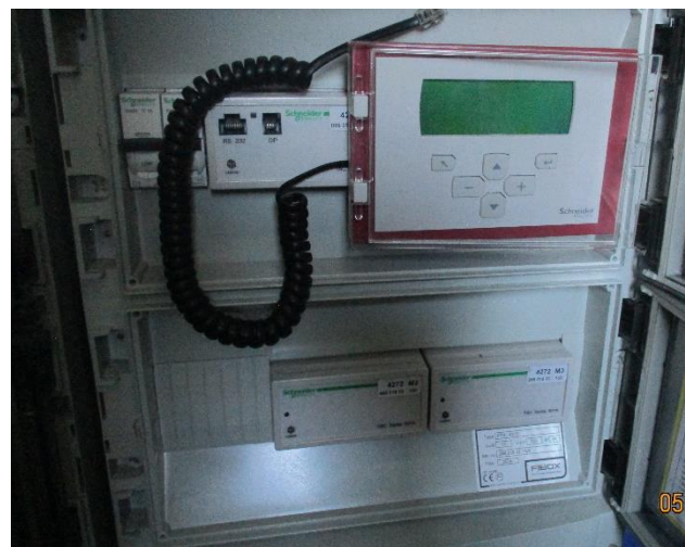
Kuva 8.18 VAK1 sisältää kaukolämmön alajakokeskuksen ohjaukset.
