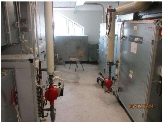
Kuva 8.3 TK04 ja TK05 samassa konehuoneessa.
