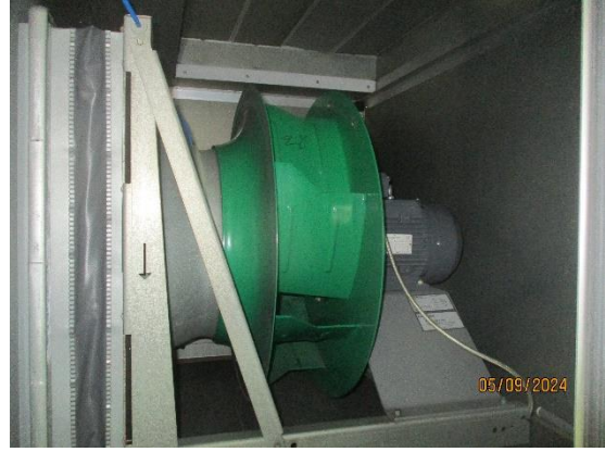
Kuva 8.6 TK05 suoravetoiset puhaltimet PM-moottorein, taajuusmuunta- jaohjatut
