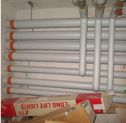
Kuva 5.7 Uusittuja putkiverkostoja teknisestä tilasta.
