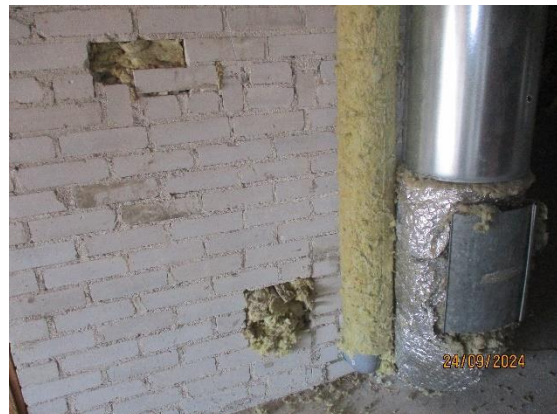
Kuva 8.8 Ullakkotilojen siivoukseen tulisi kiinnittää huomiota
