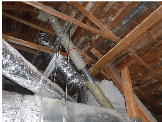
Kuva 6.27 Viemärin kannakointi reikänauhalla nykypäivänä kielletty, eristyksissä paikoin puutteita.
