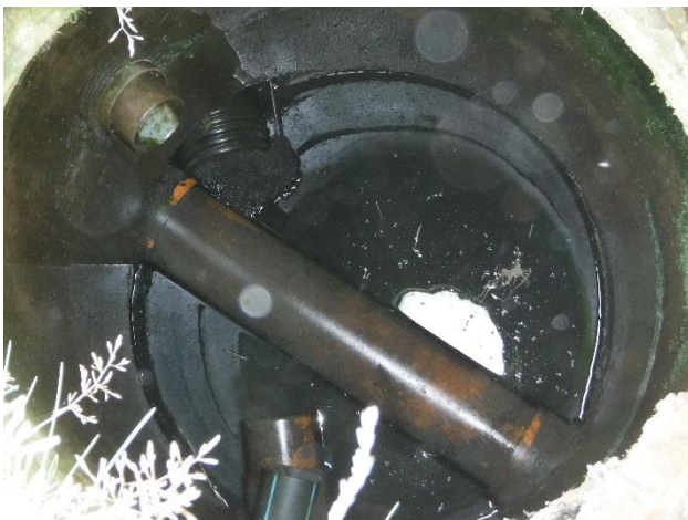
Kuva 7.1 Sadevesikaivo, johon johdettu salaojaputki ilman pallopadotusventtiiliä.
