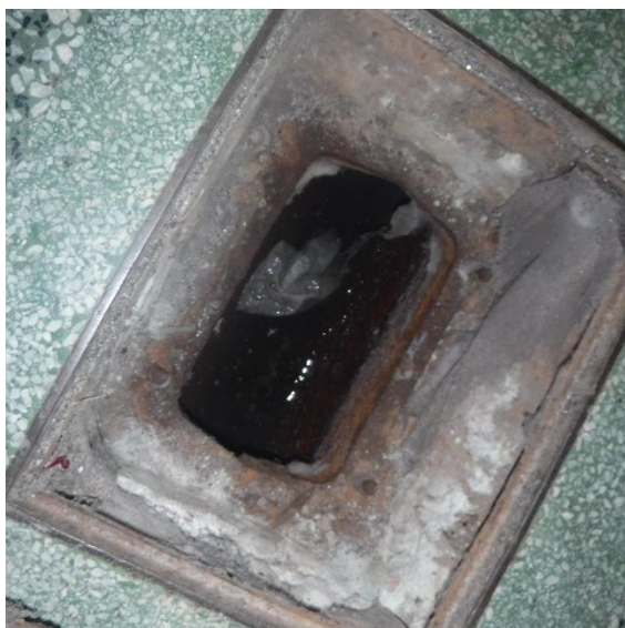
Kuva 6.22 Jäteveden valurautapohjaviemärissä vesi seisoo, täyttöaste 90%. Tulvariski.
