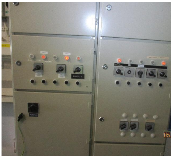
Kuva 8.21 IV-konehuoneissa myös käsikäyttökytkimet.
