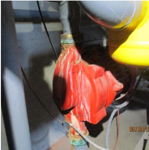
Kuva 5.3 IV-verkoston kiertovesipumpussa havaittiin aiempaa vuotoja jälkeä.
