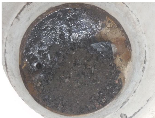
Kuva 6.24 Jäteveden tarkastuskaivossa irtoaines padottaa pohjakourua.
