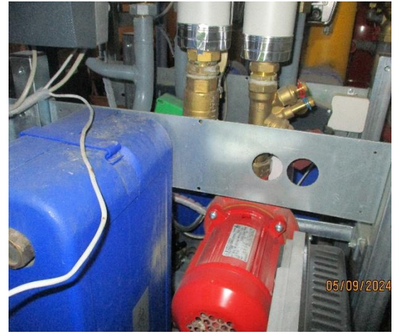
Kuva 6.2 Käyttöveden lämmönsiirrin ja verkoston pumppu.
