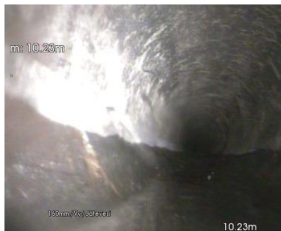
Kuva 6.25 Muovinen jätevesiviemäri kunnossa.
